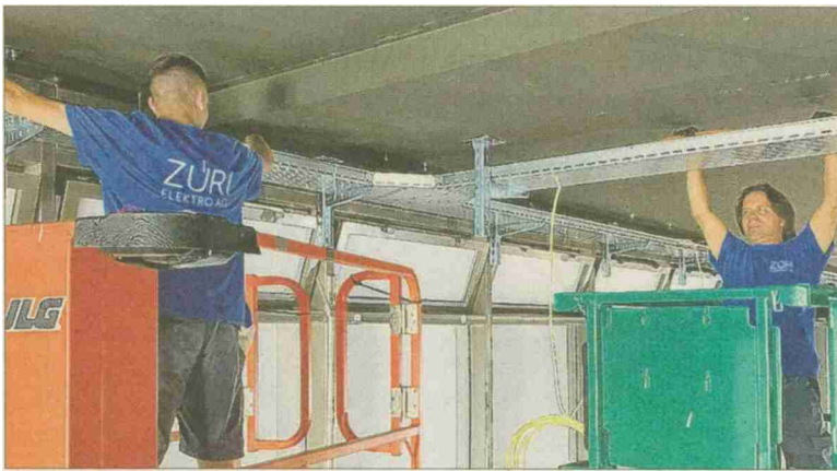
Szene von der Baustelle, wo es meist laut zu und her geht. Das hat die Züri Elektro AG nicht davon abgehalten, einen gehörlosen Mitarbeiter einzustellen.
